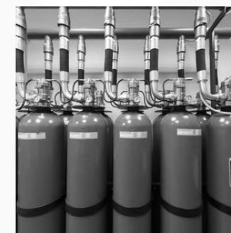
IMPIANTI DI SPEGNIMENTO A GAS INERTE
