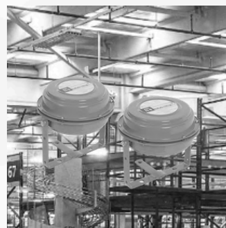
SISTEMI DI ESTINZIONE AD AEROSOL CONDENSATO
